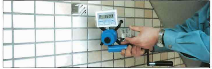
(外装タイル接着強度測定)
