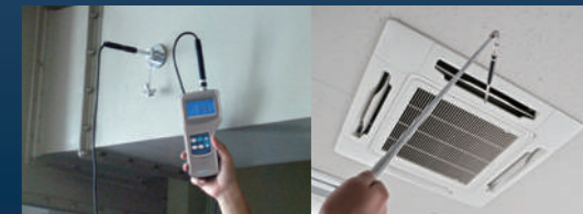
空調機器の能力試験・保守点検
