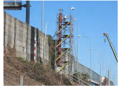
軽量鋼管タワー
