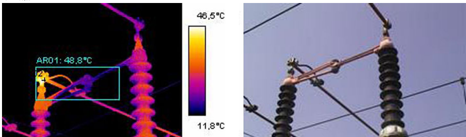
図 17.1 電源遮断機の熱画像と実画像
