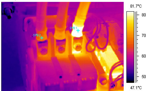
図 17.8 屋内電気設備の熱画像 (1)。
