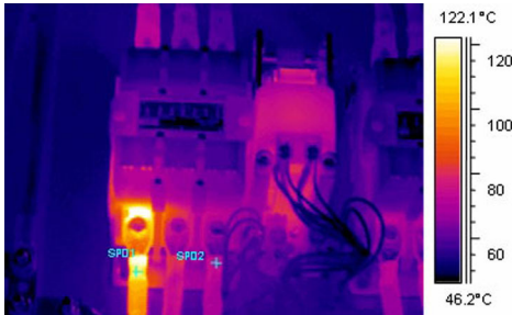
図 17.9 屋内電気設備の熱画像 (2)。
